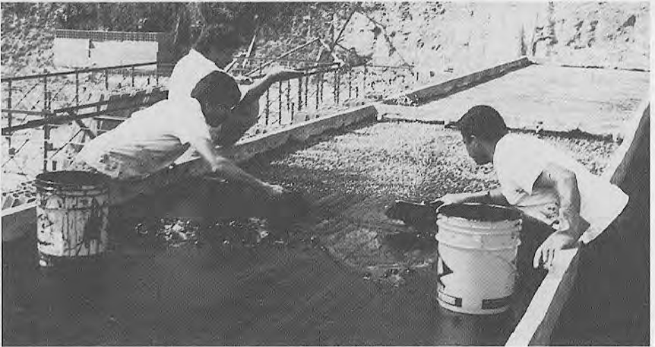
Fig. 12.8. Bancadas selladas con pintura bituminosa. (Cortesía de Hidroponías Venezolanas, S.A., Caracas, Venezuela).
